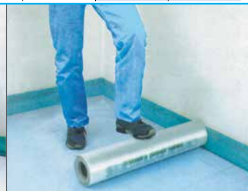
Etendue de la feuille protectrice en PE, épaisseur minimum 0,15 mm., en superposition aux bords.
